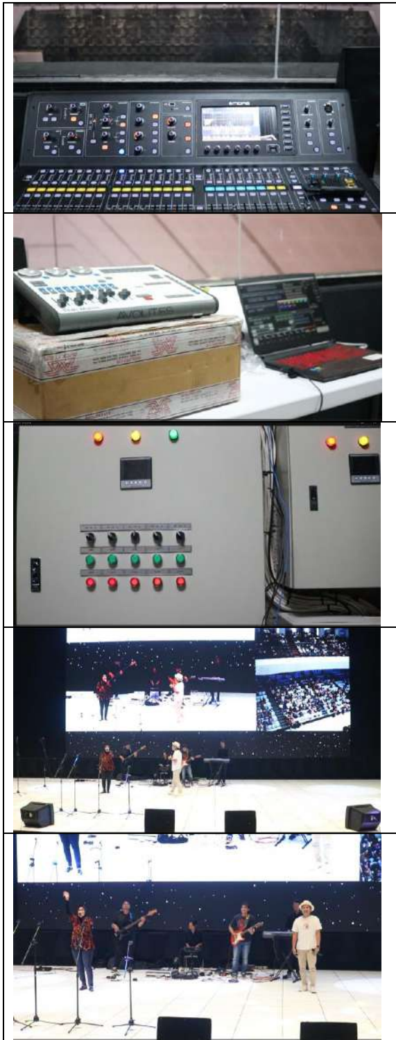
Gambar 7. Ruang server dengan peralatan yang menghandle mekanikal elektrik di saat uji coba, baik untuk penchayaan/lingting maupun sound system audio visual.
